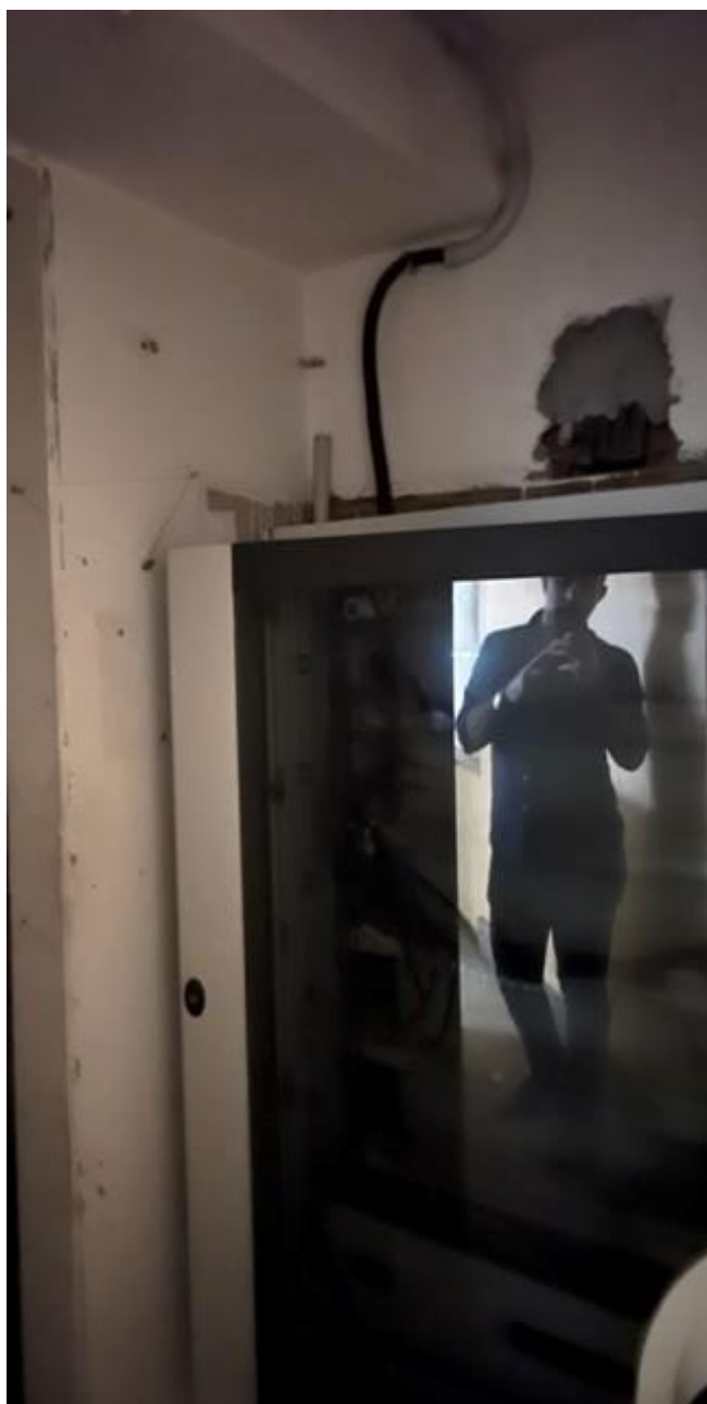
Quadro elettrico all' ingresso
