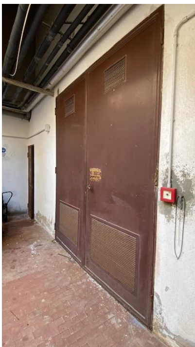
esempio porta esistente (centrale idrotermica)
