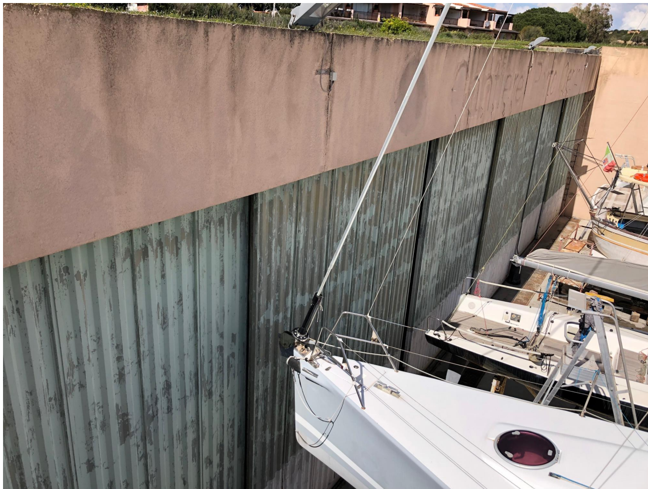
Portelloni da ristrutturare
