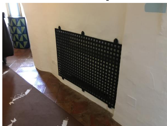
Foto 6. Corridoio / Griglia protezione fan-coil
